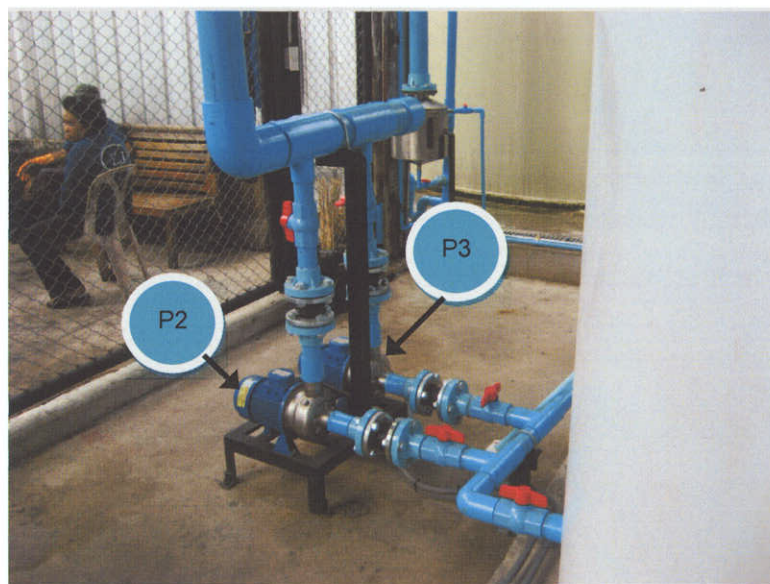
รูปที่ 4-15 รูปแสดงขั้นตอนการเปิดสวิตช์เครื่องสูบน้ำเวียนตะกอน
