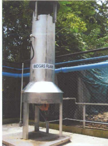
รูปที่ 3-12 ระบบเผาก๊าซชีวภาพส่วนเกิน (Biogas Flare)
