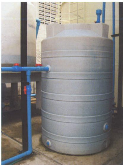
รูปที่ 3-6 ถังตกตะกอน
