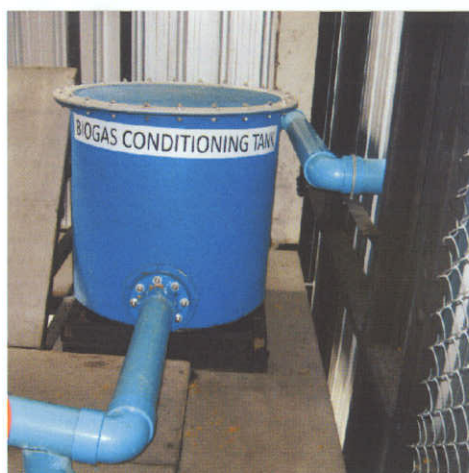
รูปที่ 5-2 แสดงถังกำจัดก๊าซไฮโดรเจนซัลไฟด์
