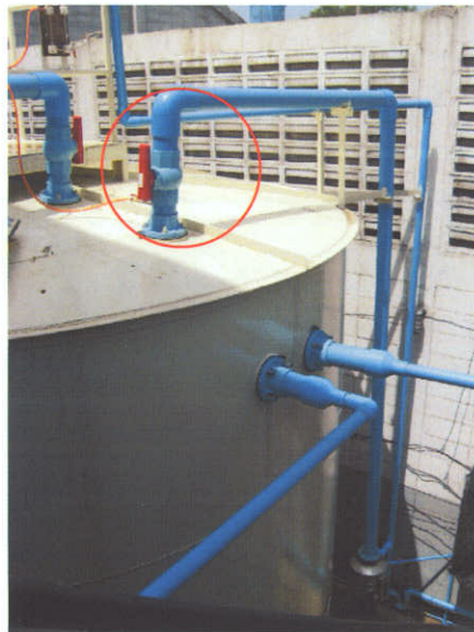
รูปที่ 4-24 แสดงสภาพวาล์วในท่อนำก๊าซชีวภาพไป Overpressure
