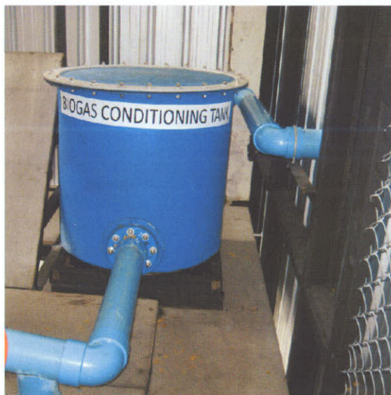
รูปที่ 3-10 Biogas Conditioning Tank
