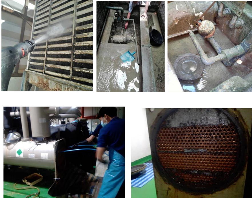
รูปที่ 10 การดำเนินการมาตรการบำรุงรักษาระบบแลกเปลี่ยนความร้อนเครื่องทำน้ำเย็น
