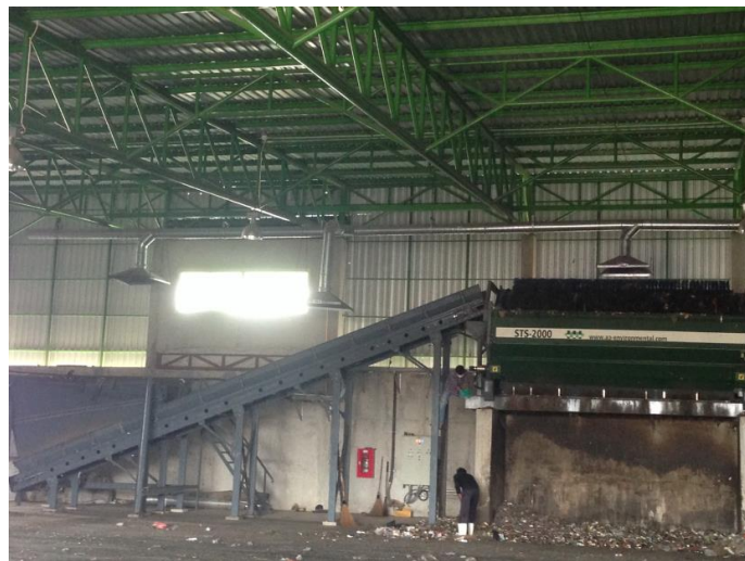
โครงการกำจัดขยะเทศบาลตำบลสูงเนิน จังหวัดนครราชสีมา
